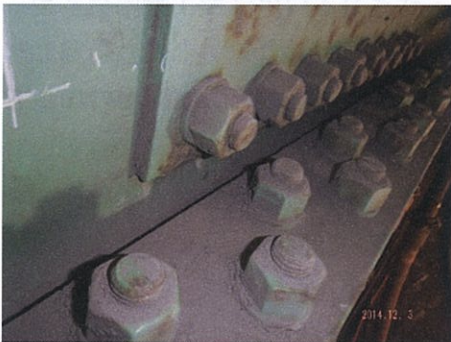
写真一8 狭隘部施工不能箇所
